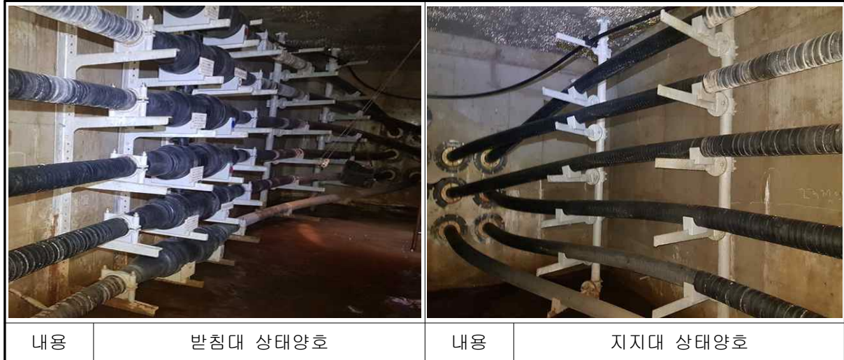
【사진 9.32】 부속 및 부대설비 현황
