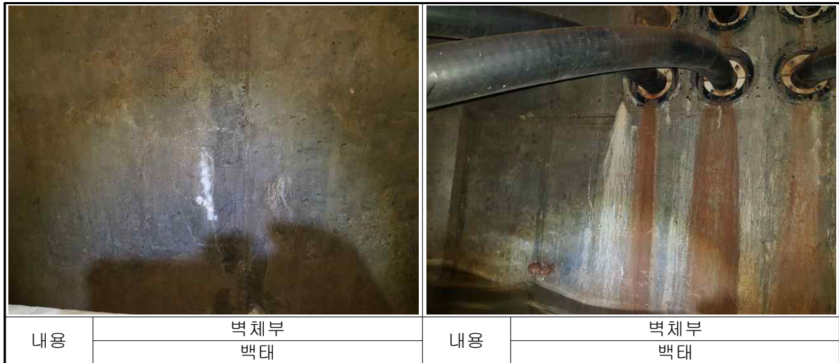
【사진 9.18】 맨홀 내부 주요 손상
